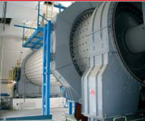
Цех помола цемента с мельницей Ø 4,0 x 13,75 м с посадкой на сегментных подшипниках
