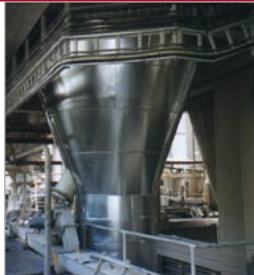
Воздушный сепаратор LTRR 2500 в цехе помола сырья 105 тн/час – цементный завод Rezola, Arrigoriaga, Испания
