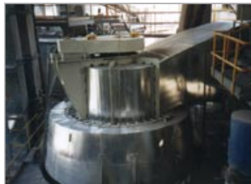
Воздушный сепаратор LTRR 2500 в цехе помола сырья 105 тн/час – цементный завод Rezola, Arrigoriaga, Испания
