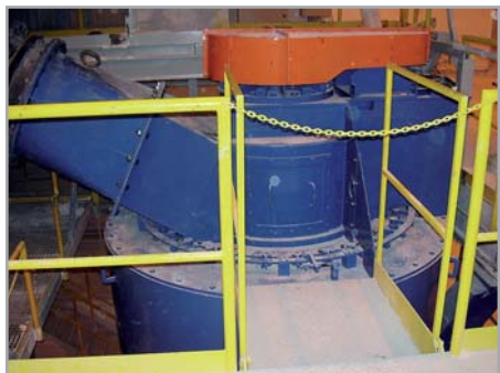
Сепаратор мельницы DTIM 1500 установленный на вертикальной мельнице КТМ 1400
